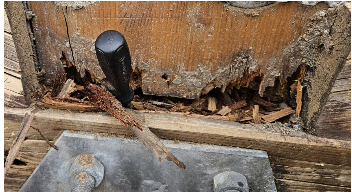
Styčnick č. 19 dolního pasu po mechanické kontrole
