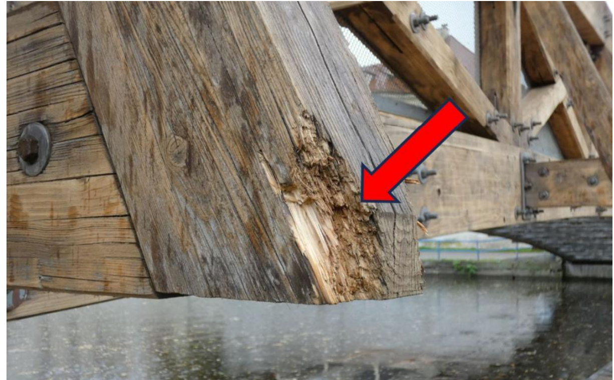
Degradovaná příčná vzpěra
