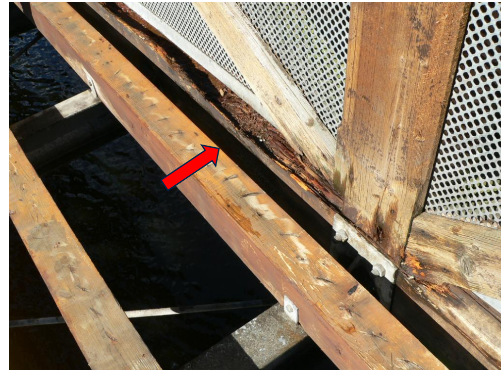
Degradace dolního pasu
