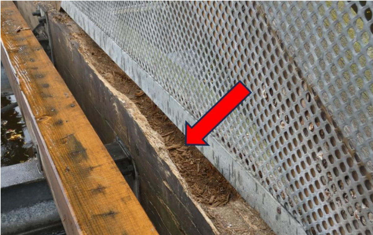
Poškození dolního pásu vazníku
