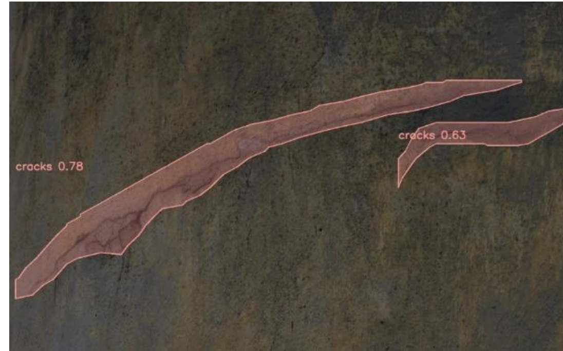
Detail detekce vady typu "Cracks / trhliny".
