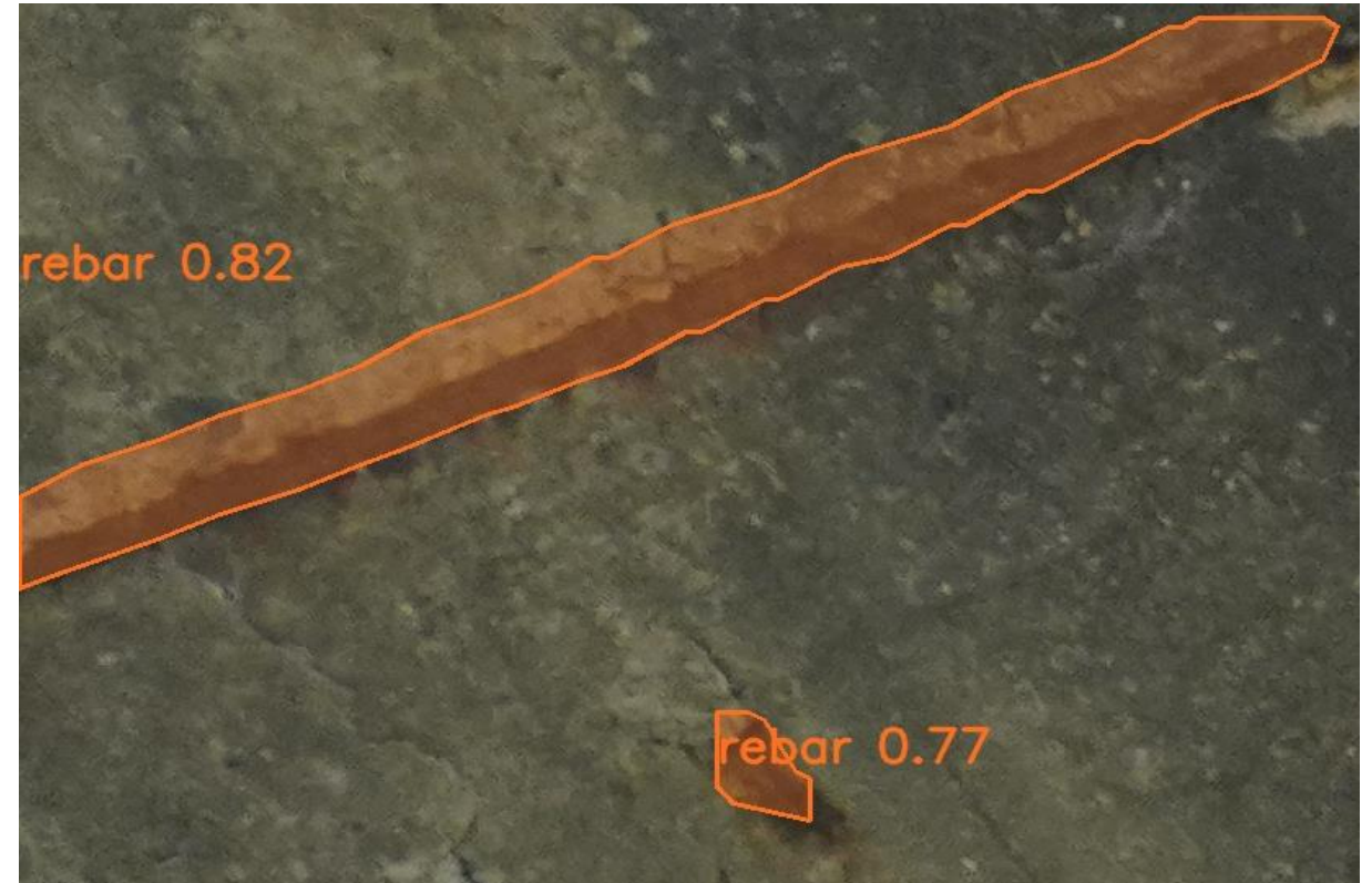
Detail detekce vady typu “Exposed rebar / obnažená výztuž”
