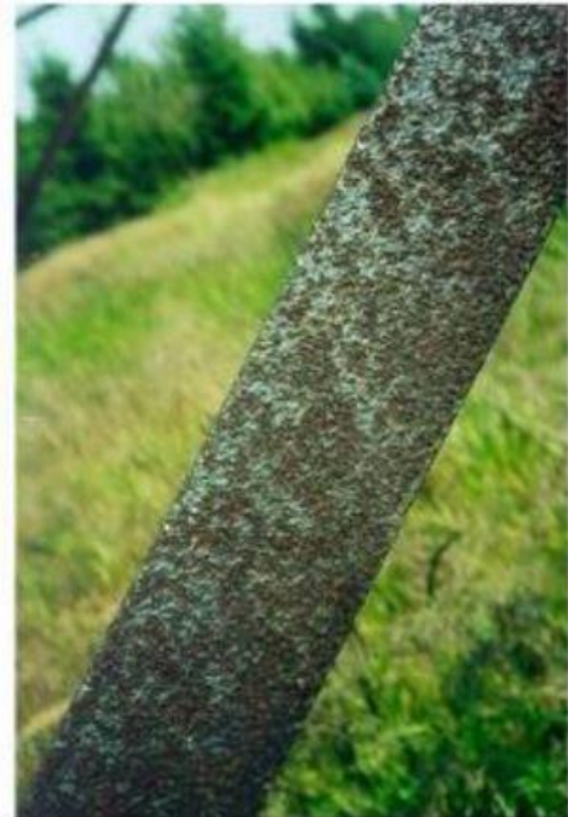
Patinující ocel - méně ochranná vrstva patiny
